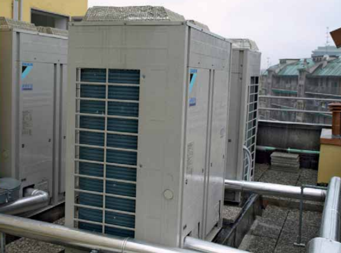
Le unità esterne del sistema VRF sono installate sulla copertura.
